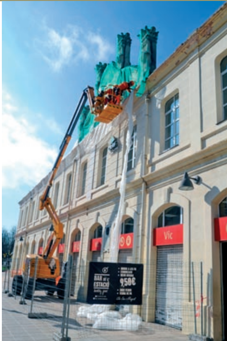
Operaris col·locant una xarxa protectora a la façana de l'estació de Vic
