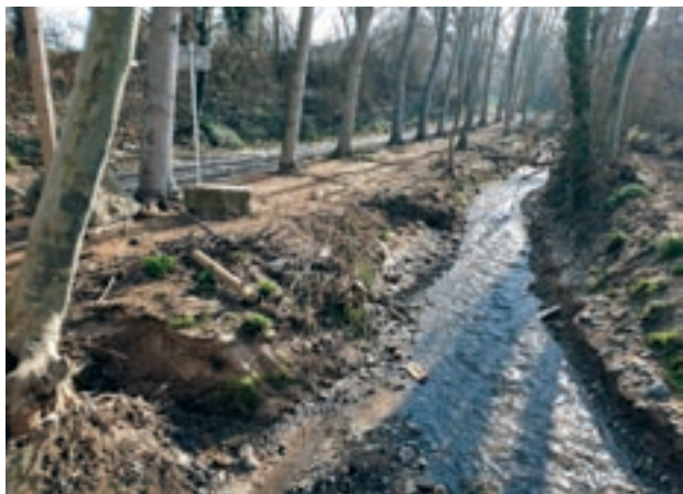
L'EMPREMTA DEL 'GLÒRIA' Els efectes del temporal són encara ben visibles, com en aquest tram, amb brançams i alguns pals de la senyalització caiguts a tocar de la llera del torrent
