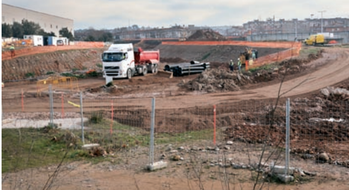
Des de fa uns dies, hi torna a haver activitat a la zona on es construirà l'estructura del nou pas per sota les vies de l'R3
