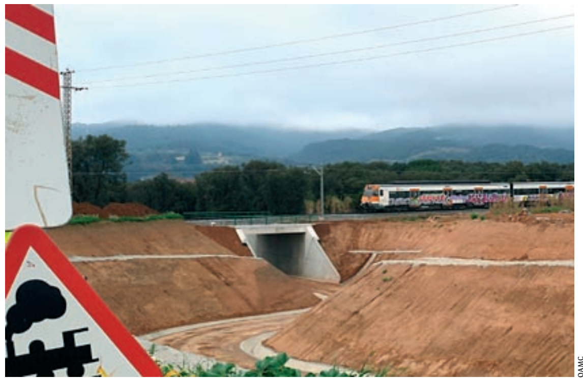
Un tren passant per damunt del nou pas inferior que s'ha construït a la Garriga, amb el vial encara per pavimentar
