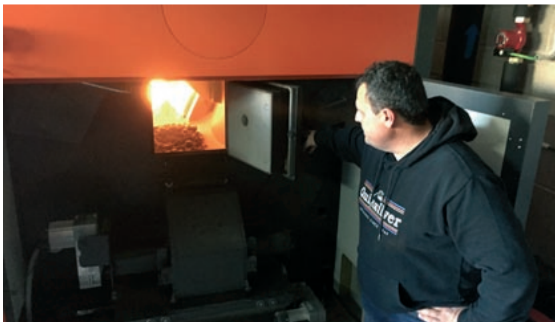
Un membre de l'empresa instal·ladora observa el funcionament de la caldera aquest dilluns
