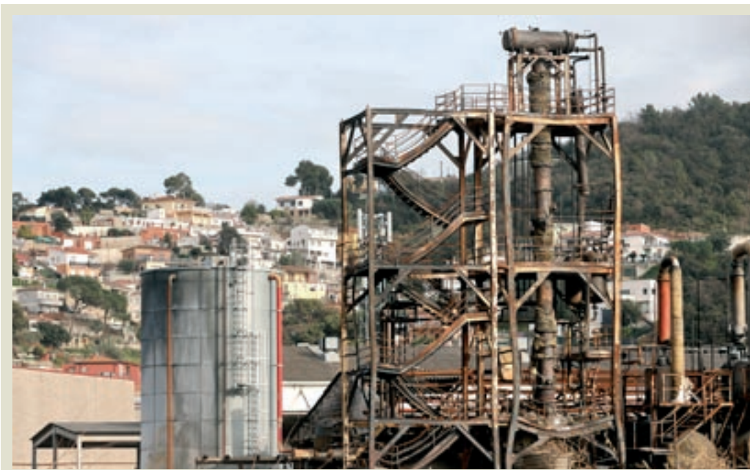
Les instal·lacions de Ditecsa afectades per l'incendi aquesta setmana encara pendents del desmantellament
