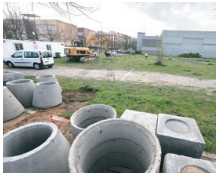
Es construeixen al solar que hi ha al costat del carrer Esteve Terrades
