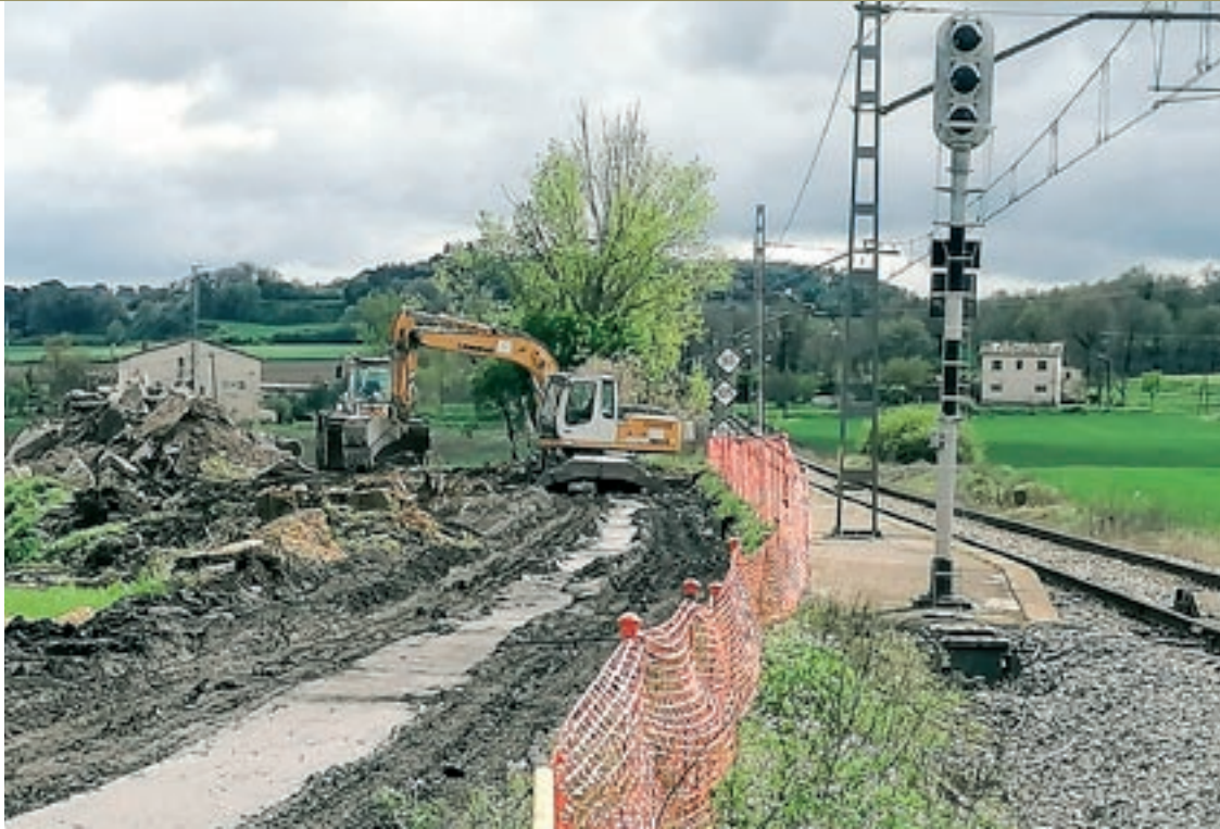
La subestació es construirà a l'espai on antigament hi havia hagut el baixador de Mont-rodon
