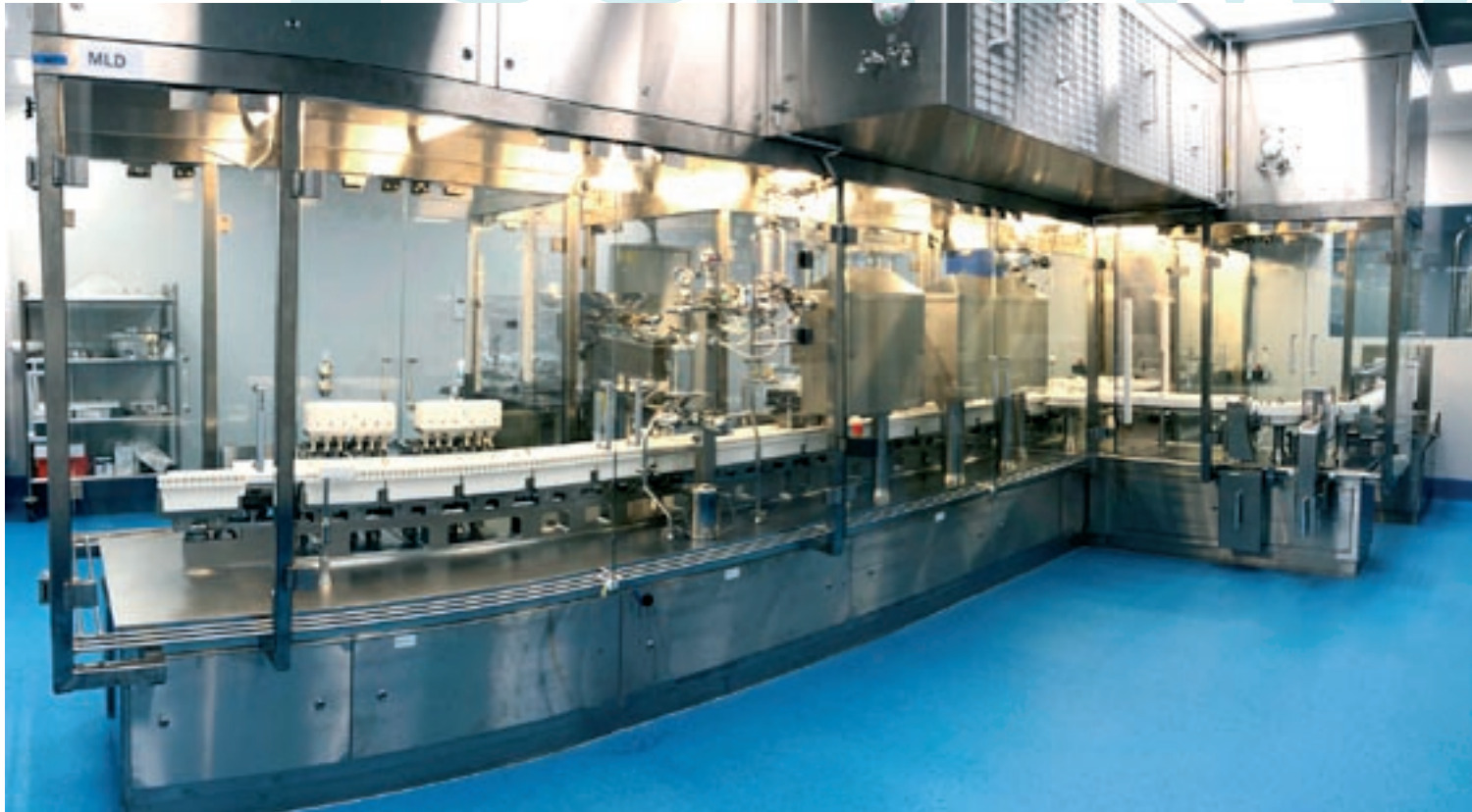
Aspecte de la nova línia de producció que Inibsa ha instal·lat a la fàbrica de Lliçà de Vall
