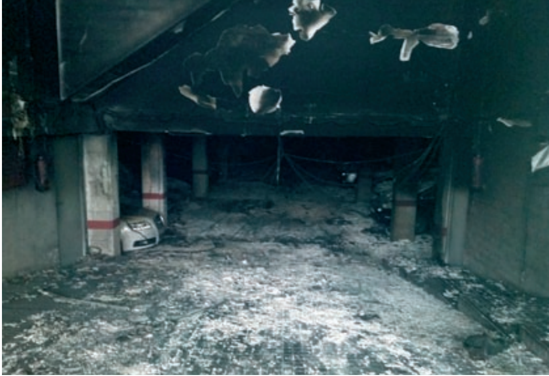
L'interior de l'aparcament del bloc d'habitatges del carrer Dolors Granés afectat per l'incendi d'aquest dilluns
