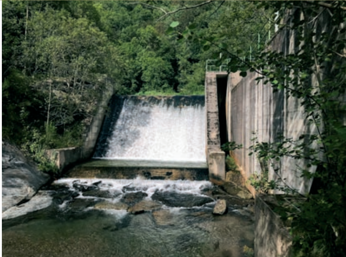
La presa i la central hidroelèctrica del Ritort a Molló es va construir a finals dels anys vuitanta
