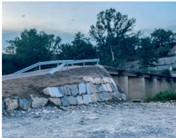
Estat del pont després de la seva obertura al trànsit, el dijous
