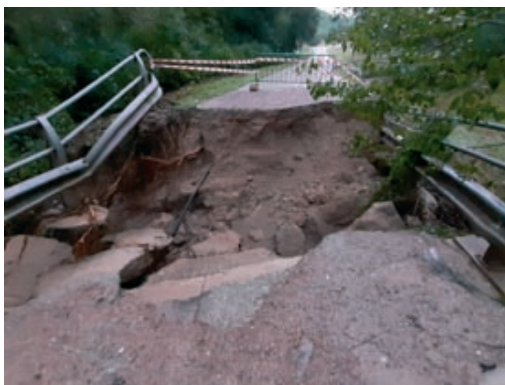
Estat en què va quedar la carretera al Molí de Puigoriol, a Lluçà
