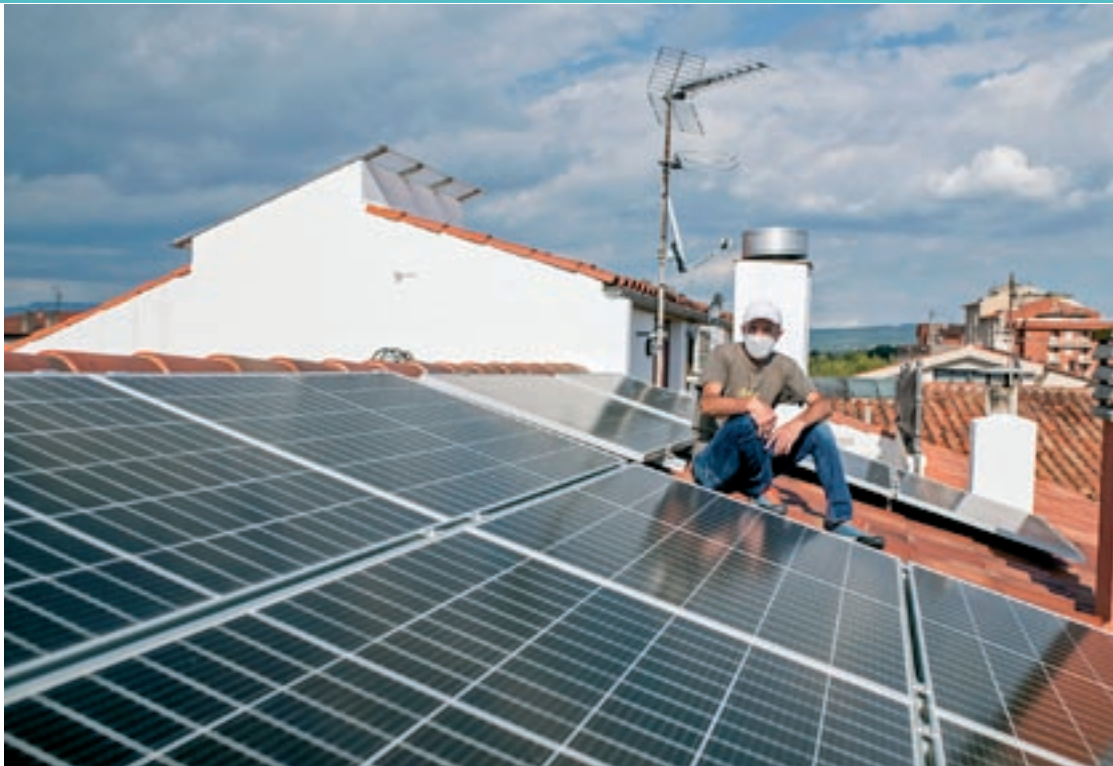
Lluís Santanach a la teulada de casa seva, on té 10 plaques connectades a unes bateries
