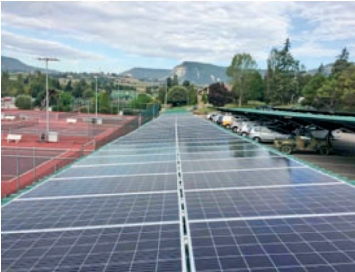
Una imatge de les plaques solars instal·lades a l'aparcament del CT Vic
