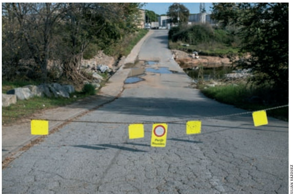
El gual de Cal Forcaire va patir danys amb la darrera riuada i l'Ajuntament ha decidit mantenir-lo tancat al trànsit
