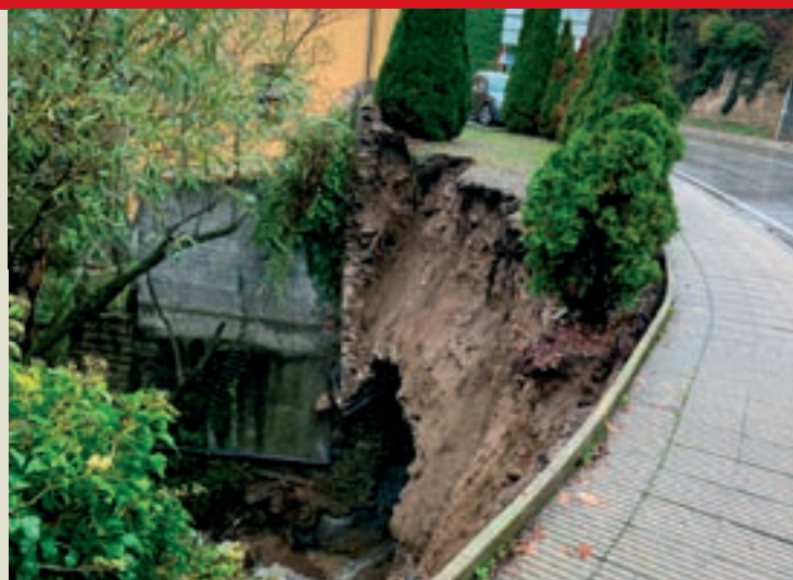
Aspecte de l'esllavissada on la carretera passa per sobre la riera d'Oganes
