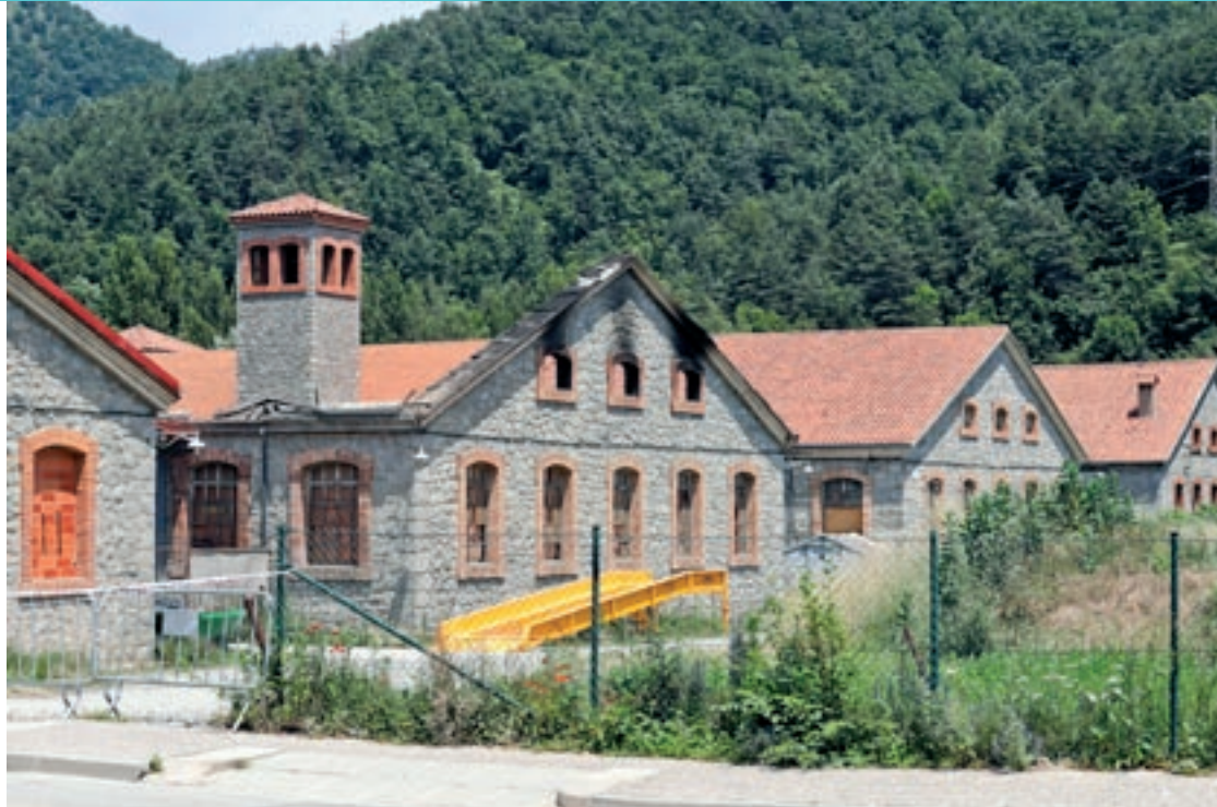
Estat exterior de la nau després de l'incendi provocat per un llamp
