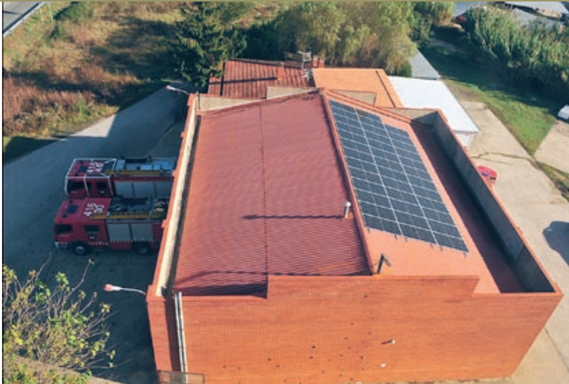
La nova instal·lació a la coberta del parc de Bombers està formada per 38 plaques fotovoltaiques
