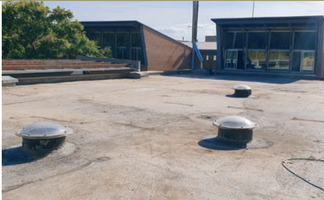
La coberta de l'escola Pinetons de la Garriga. Els treballs es fan per resoldre els problemes de degoters
