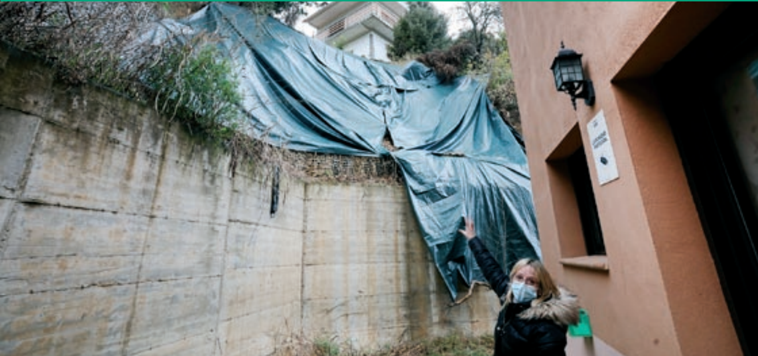
(Pàgines 2 a 4) Carmen Hernández, veïna de Can Bosch, a Palautordera, afectada per les esllavissades a casa seva
