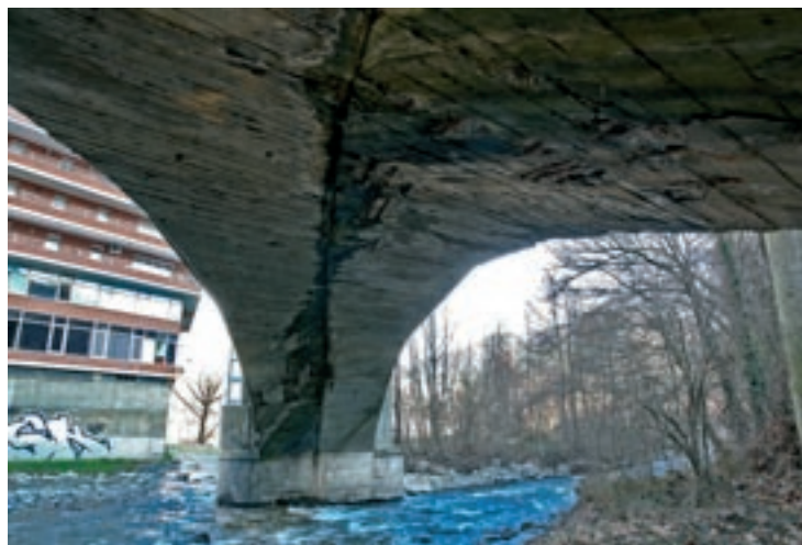
En l'estructura del pont del tren s'hi aprecien diversos desprendiments
