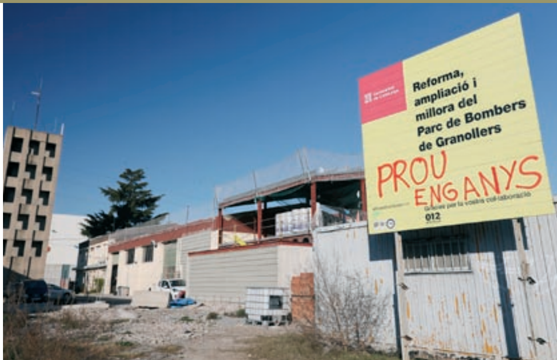
La instal·lació de nous contenidors per als treballadors de l'obra és el primer senyal de la represa de les obres
