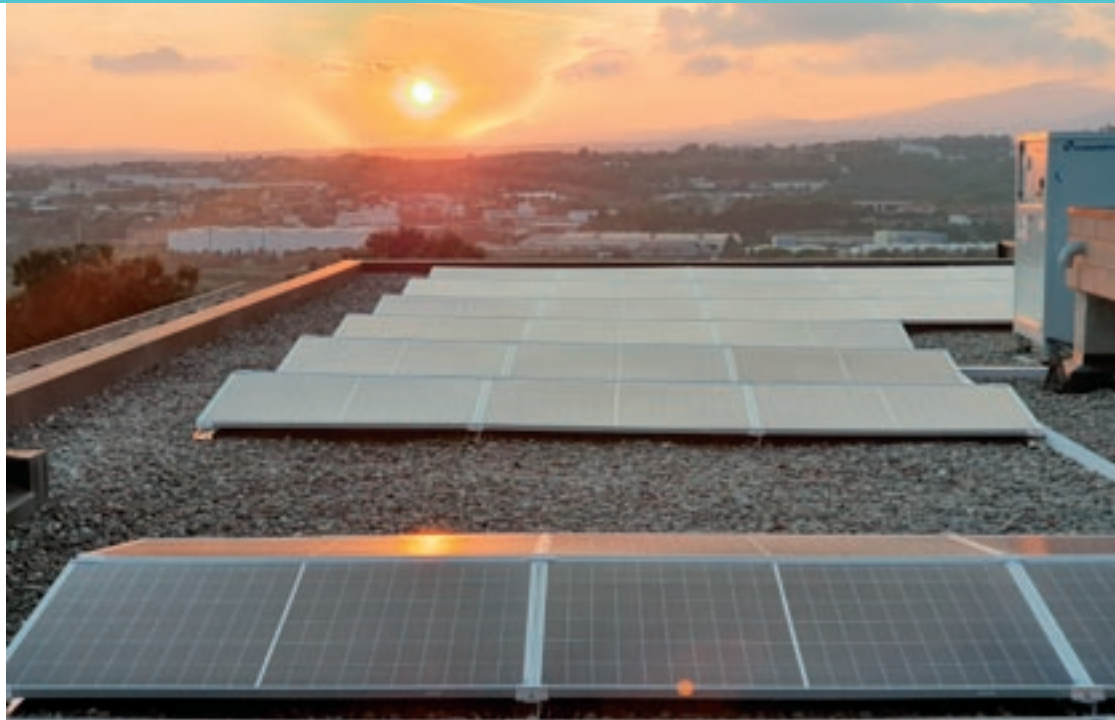
Les noves plaques d'Epidor, a Lliçà de Vall, subministren una quarta part de les necessitats d'energia de la planta
