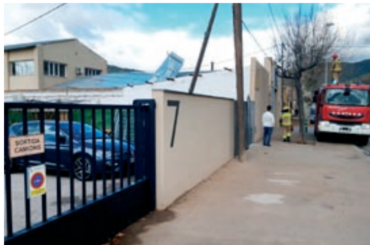
Els Bombers treballant a la nau de la carretera de Vic, a la Garriga
