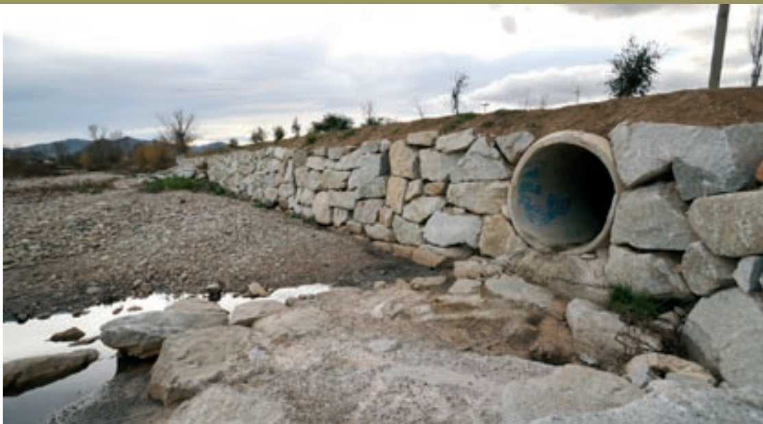
El nou mur que substitueix el tram d'escullera de formigó arrencada pel Congost a la zona de Palou, a Granollers
