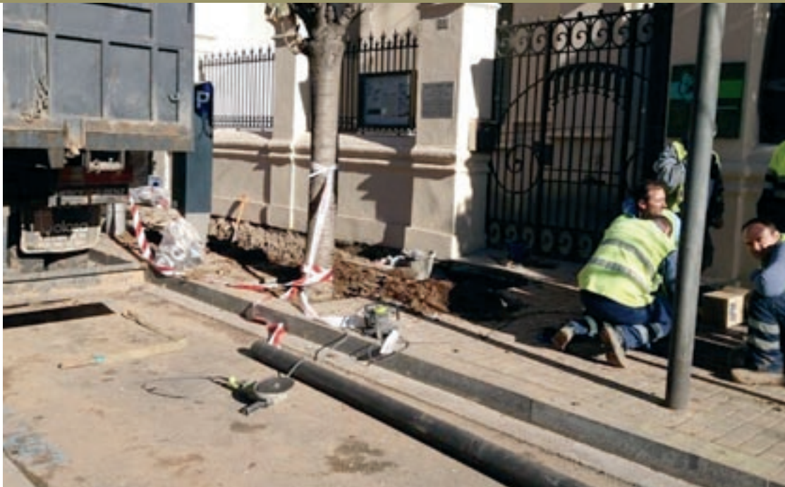
El mal estat de les canonades ha estat la causa de diverses avaries a la xarxa en els darrers anys
