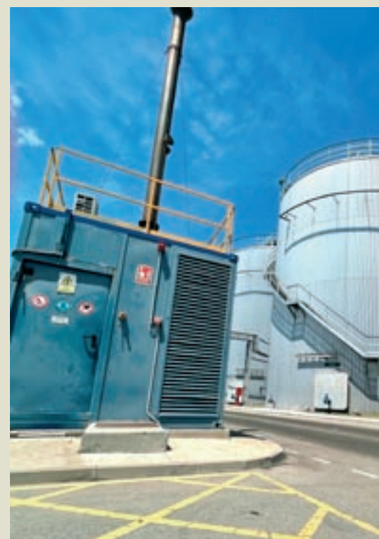
Un dels motors de cogeneració i els digestors on es processa la brossa orgànica.
