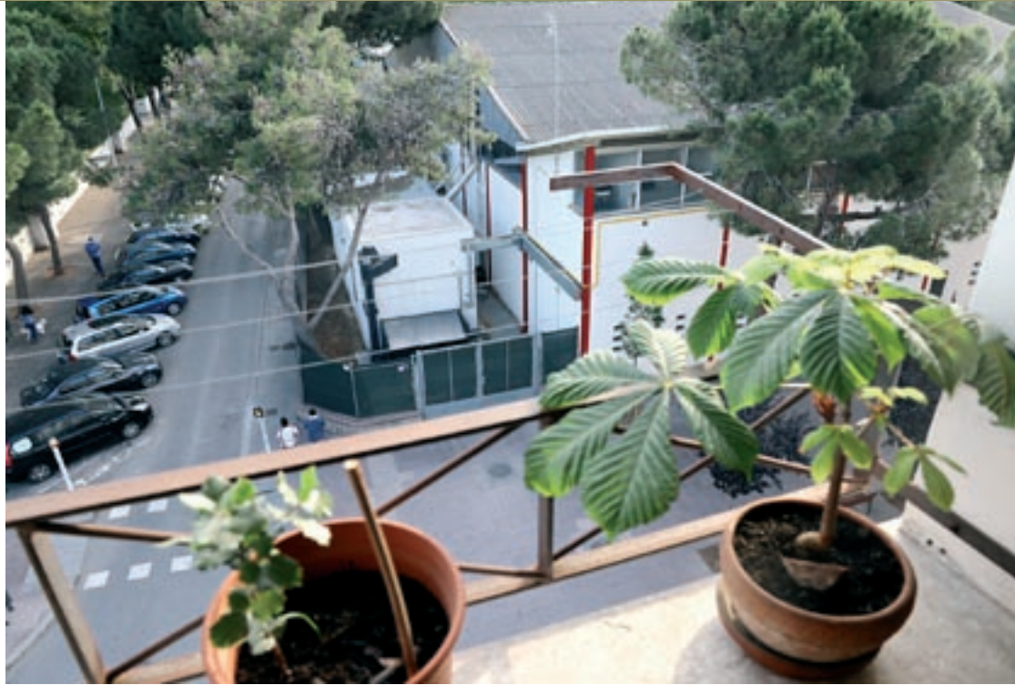
La caldera de biomassa vista des d'un edifici de l'avinguda Cades, a Mollet
