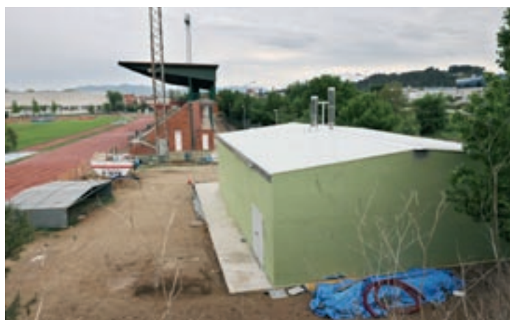
La nova instal·lació al costat de les pistes d'atletisme i el passeig Fluvial
