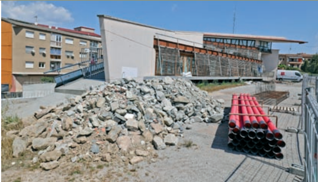
Estat actual de les obres de remodelació de l'edifici de La Pista
