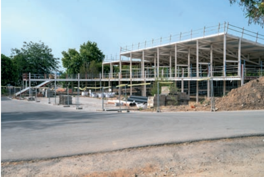
L'edifici del centre polivalent La Vinya de Carrencà resta inacabat des de fa prop de dos anys
