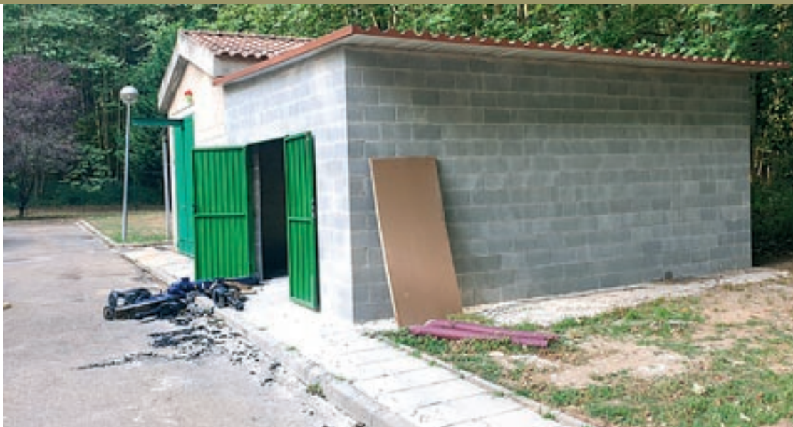
La caseta on hi va haver l'incendi està envoltada de massa forestal
