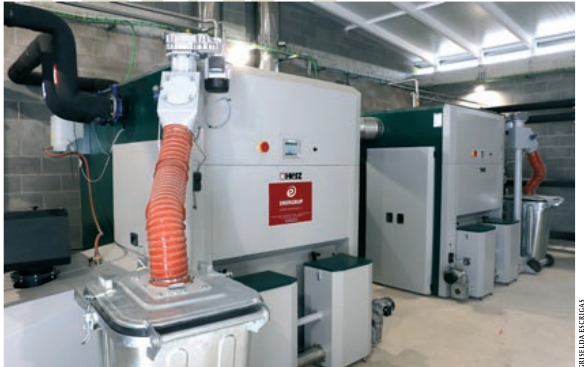
La caldera de biomassa que dona servei a equipaments de la zona sud del carrer Roger de Flor, a Granollers
