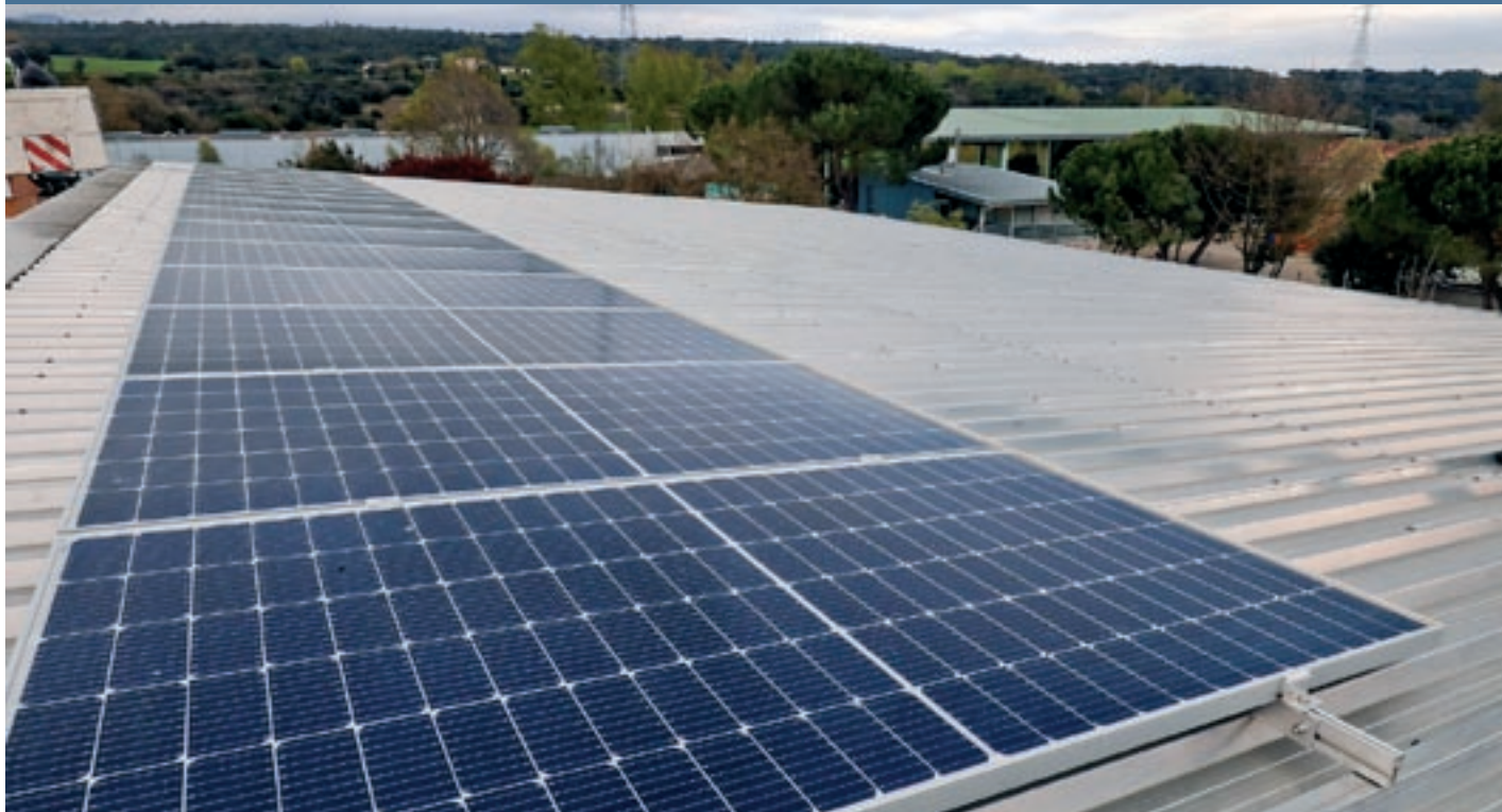
Plaques solars a la teulada de la llar d'infants de Balenyà
