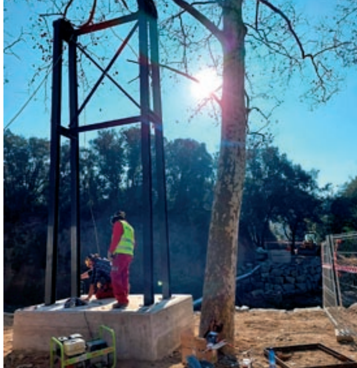
La base de la nova passera en construcció a una de les lleres de la Tordera
