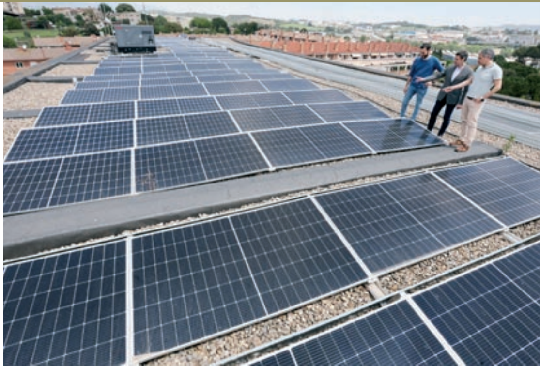
Rico, al centre, amb dos tècnics municipals a la instal·lació fotovoltaïca instal·lada a la coberta de l'ajuntament
