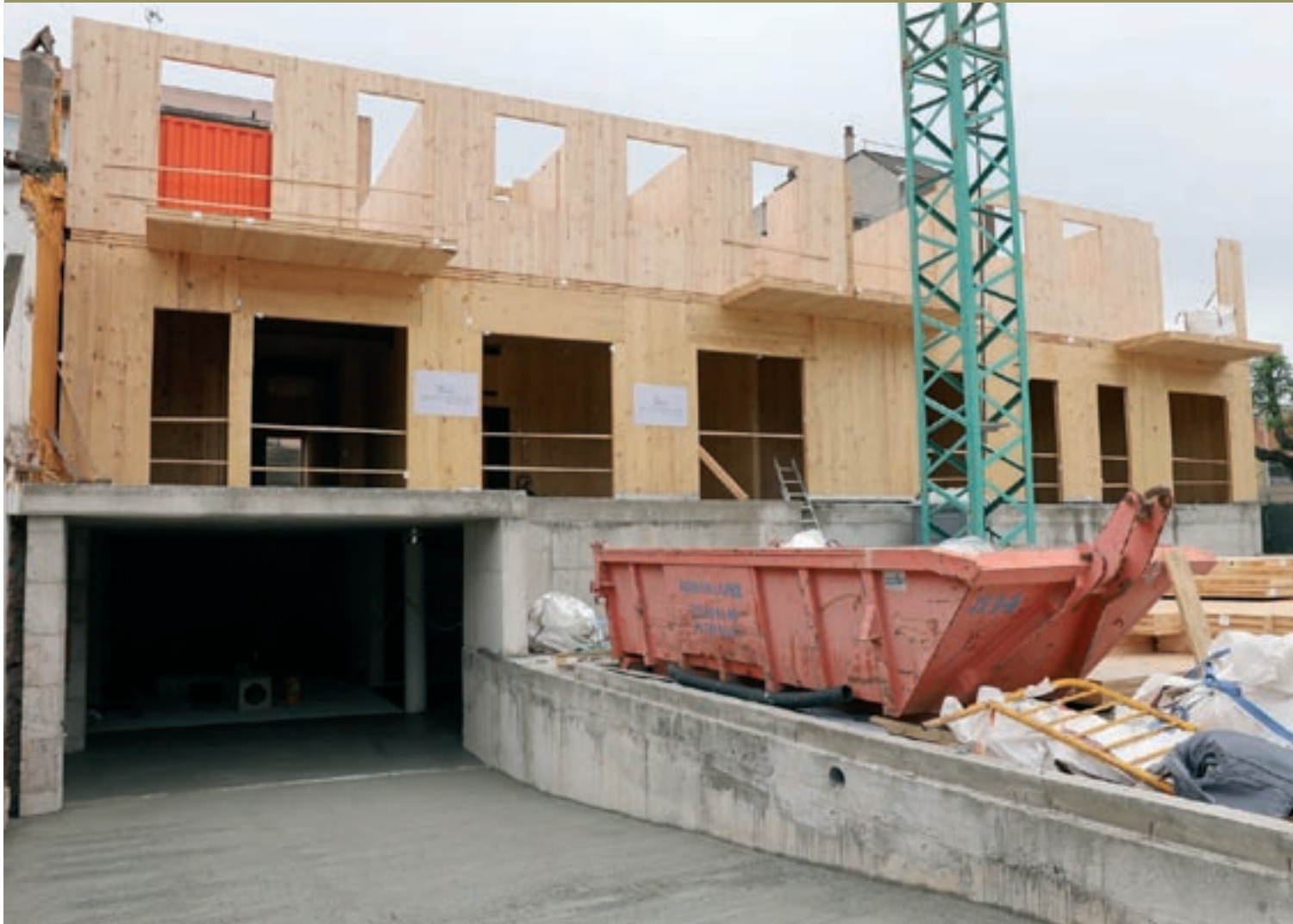
La promoció que s'està construint al carrer Girona de Granollers, vista des del carrer Felip II, on hi haurà l'accés als habitatges
