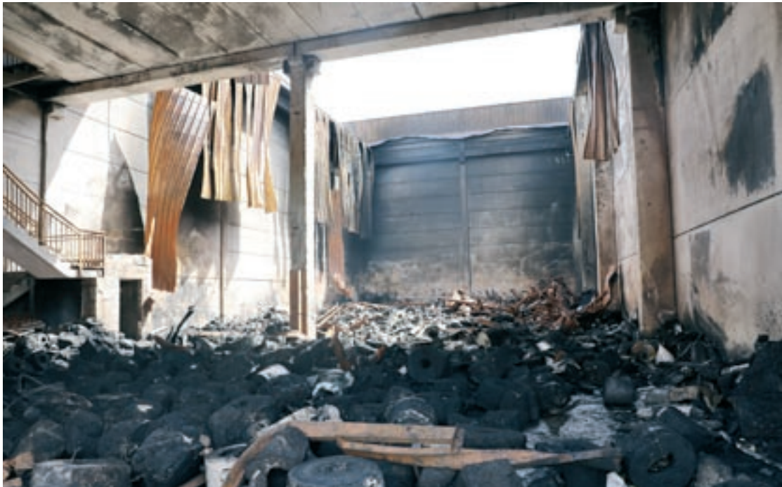
Interior de la nau de ServiCanto cremada amb el material cremat i la coberta ensorrada en una imatge d'aquest dijous
