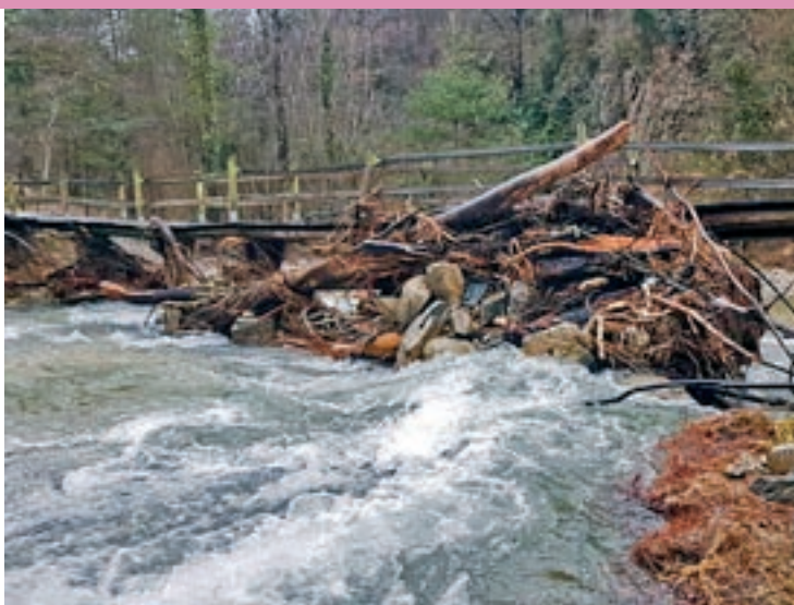
L'estat en què va quedar la passera després del temporal 'Glòria'
