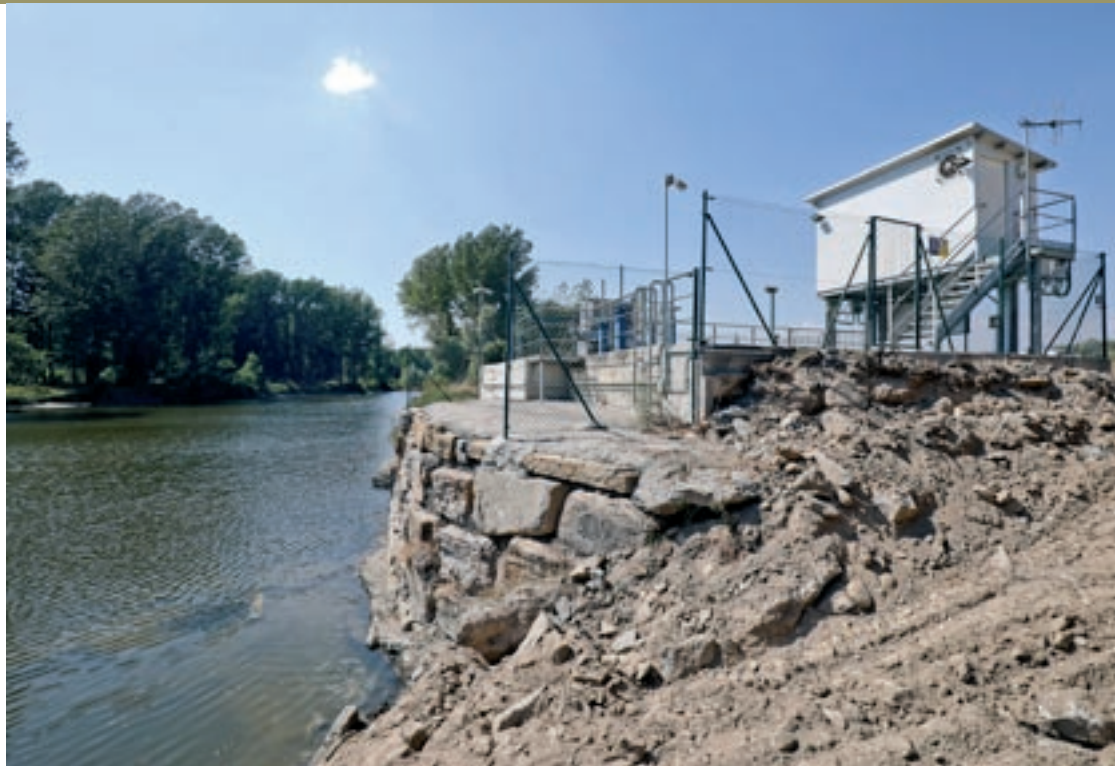
Estat del punt de captació al riu Ter de la potabilitzadora d'Osona sud, a Malars, aquest diumenge a la tarda
