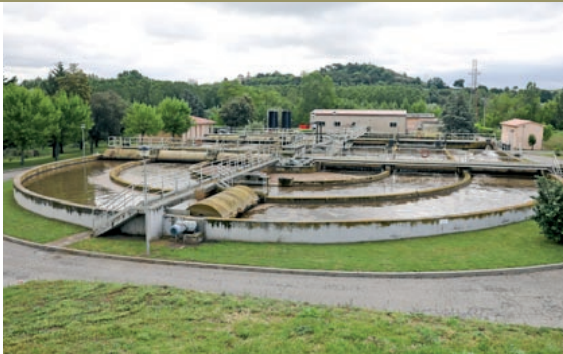
Imatge d'arxiu de l'estació depuradora d'aigües residuals (EDAR) de Torelló
