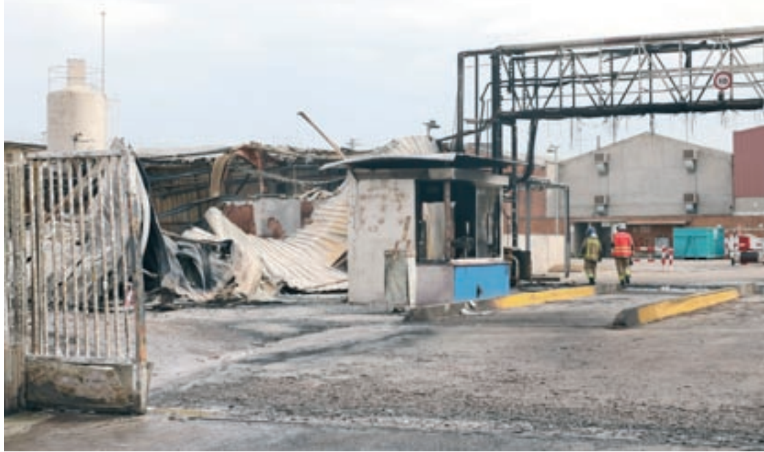
Al magatzem cremat, entre els carrers Montseny, Girona i Estació, hi havia unes 100 tones d'azodicarbonamida
