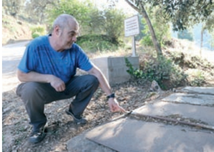
Mateu en una de les instal·lacions de la xarxa d’aigua que abasteix Figaró
