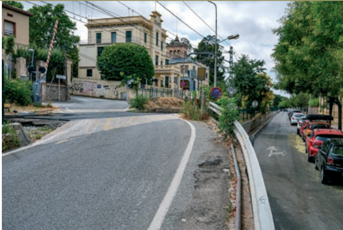
El tram de la ronda del Carril, al sud del pas a nivell de la carretera de Samalús, on es construirà un nou mur
