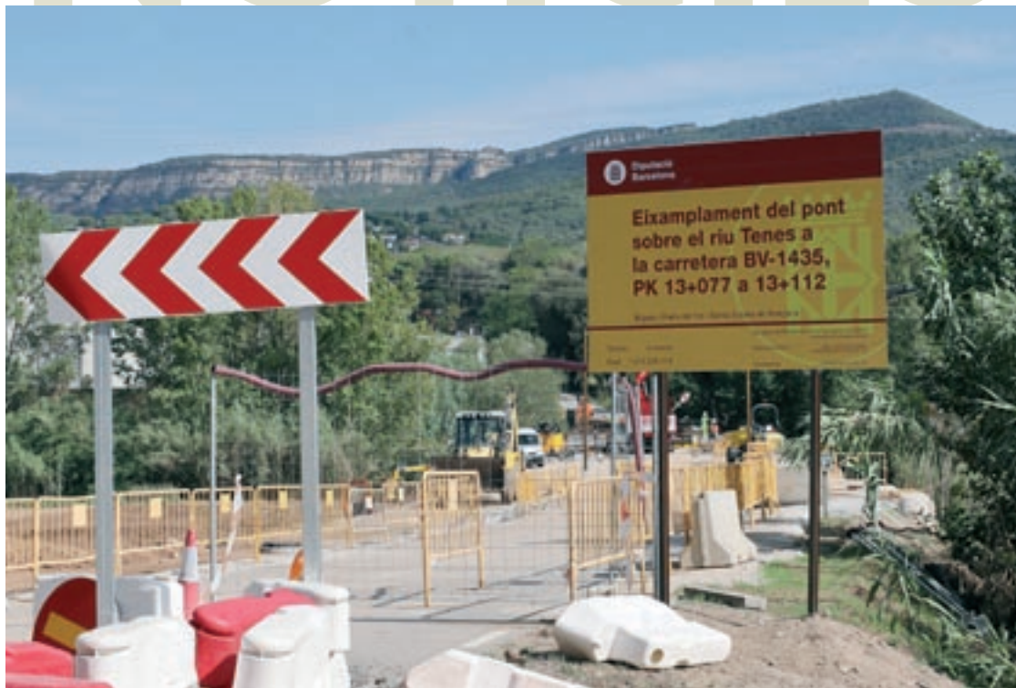
Les obres d'ampliació del Pont de Ca l'Unyó van amb retard i no es reobrirà fins a mitjan setembre
