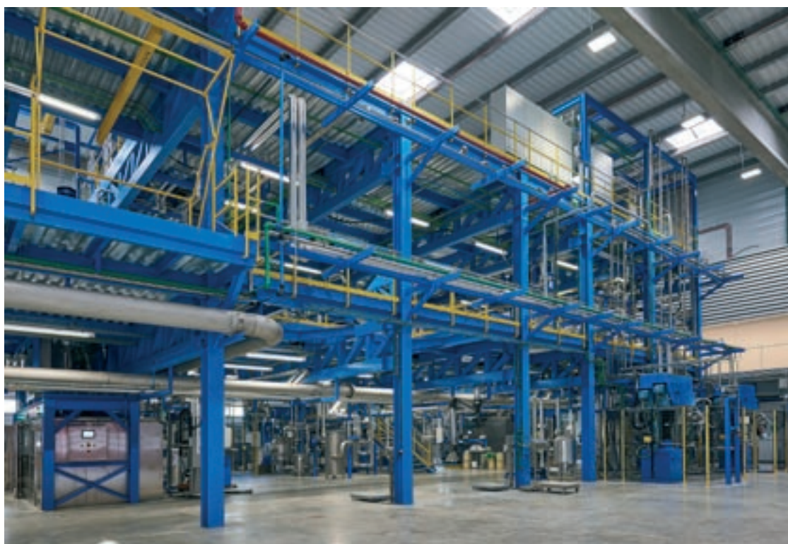
Interior de les instal·lacions de la planta d'adhesius per a la indústria aeroespacial de Henkel a Montornès
