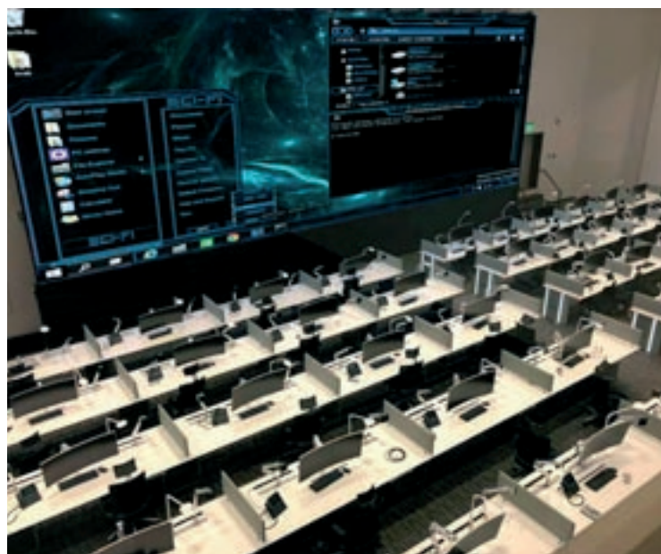
Aspecte del centre de control instal·lat a la localitat d'Al Ula
