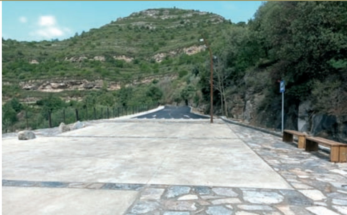
La remodelació de l'aparcament es va enllestir fa pocs dies i la Diputació ja ha recepcionat l'obra
