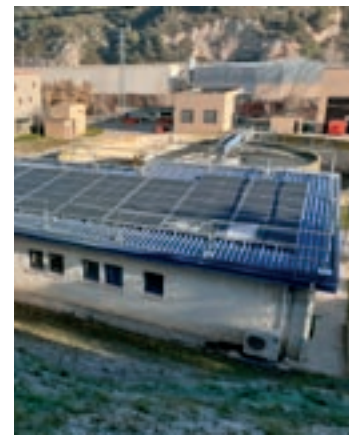
Plaques solars a les depuradores
