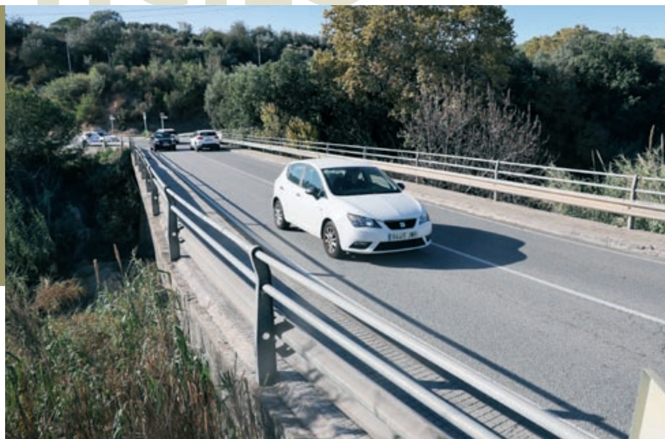
El pont de la carretera de l'Ametlla, a la sortida de la Garriga, s'haurà d'eixamplar amb un voladís per generar un espai segur per a vianants i ciclistes.
