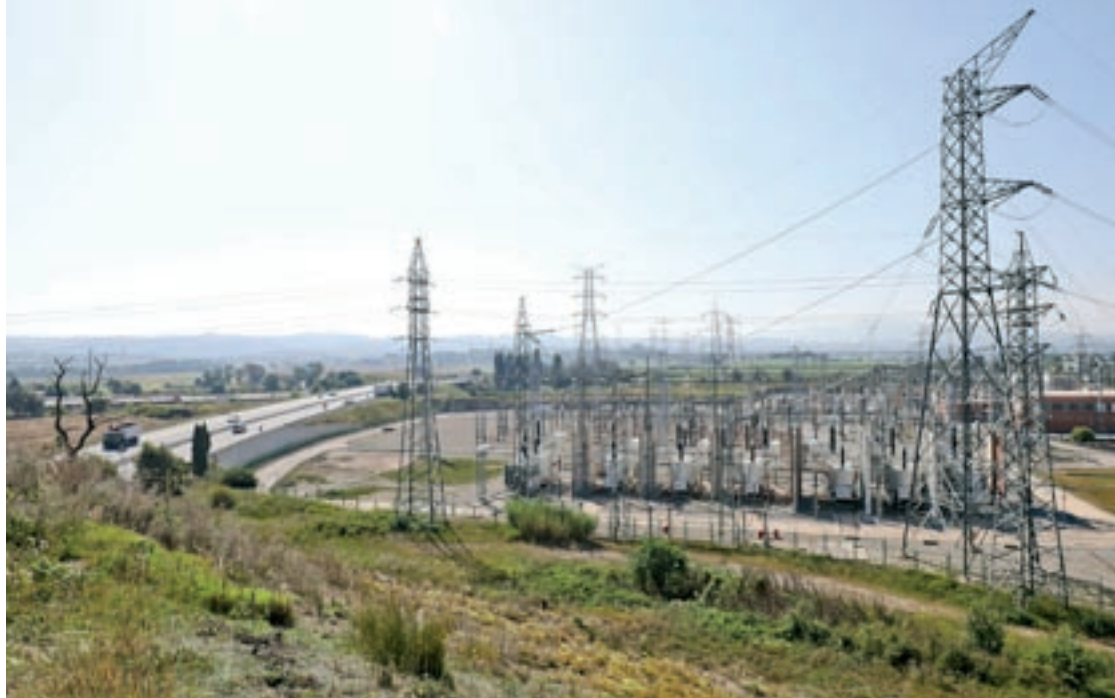
La subestació elèctrica de Vic, a tocar de l'Eix Transversal, on es connectarien els sis subparcs
