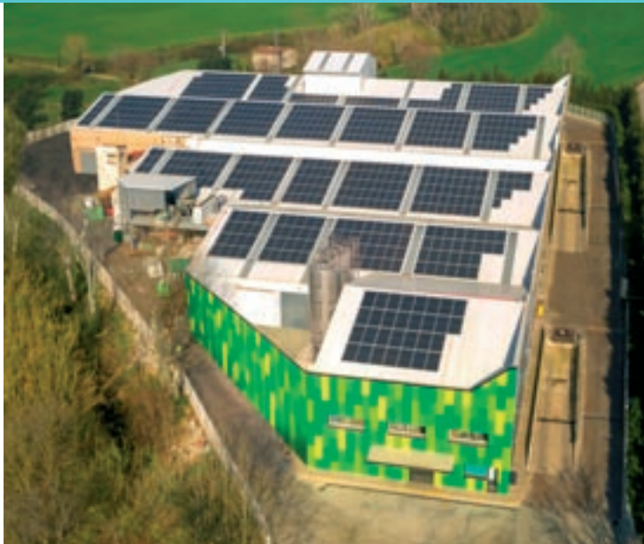
Una instal·lació de Doctor Energy en una planta industrial a Lliçà de Vall
