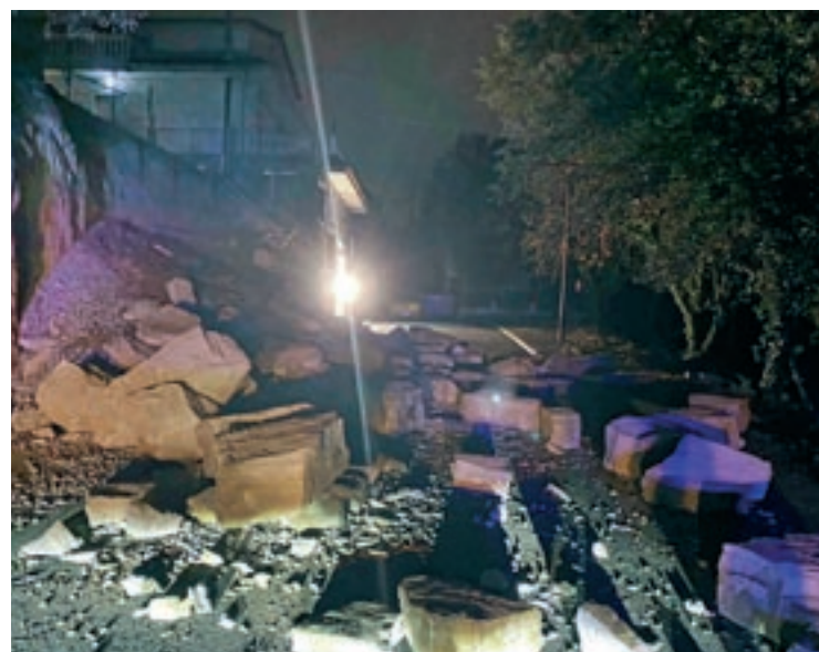
El mur de rocalla enfonsat aquest dimarts al vespre al carrer Comapedrosa
