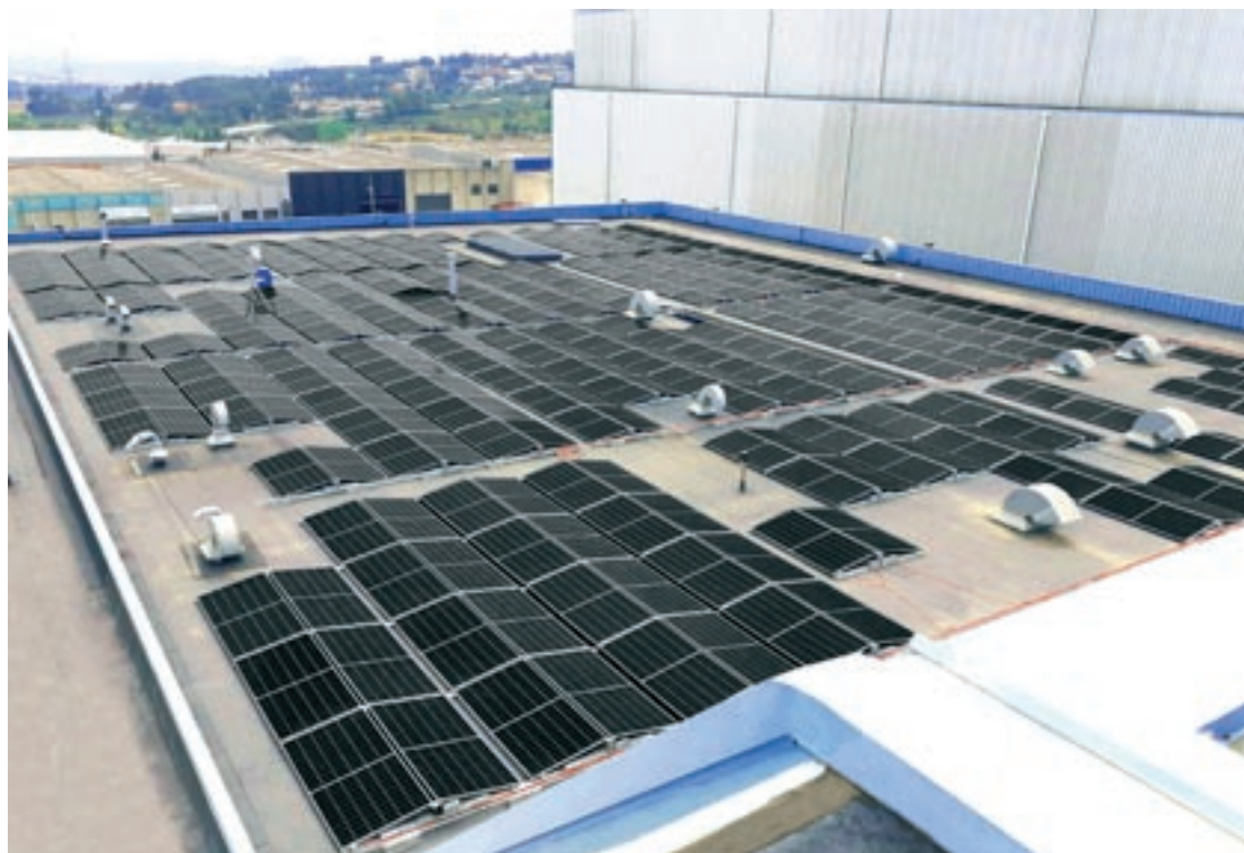
La instal·lació de plaques solars a la teulada de la seu de Kern Pharma a Terrassa
