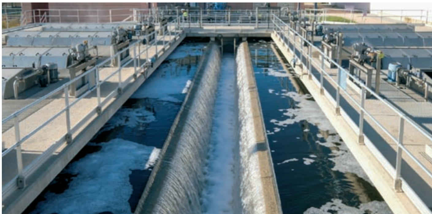
Primera fase del tractament de regeneració a l'EDAR del Baix Llobregat
