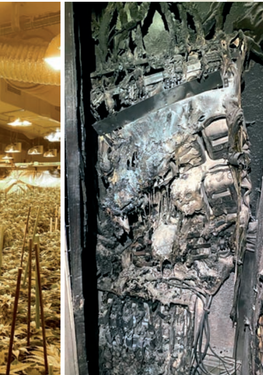
A la dreta, uns comptadors manipulats afectats per un incendi
