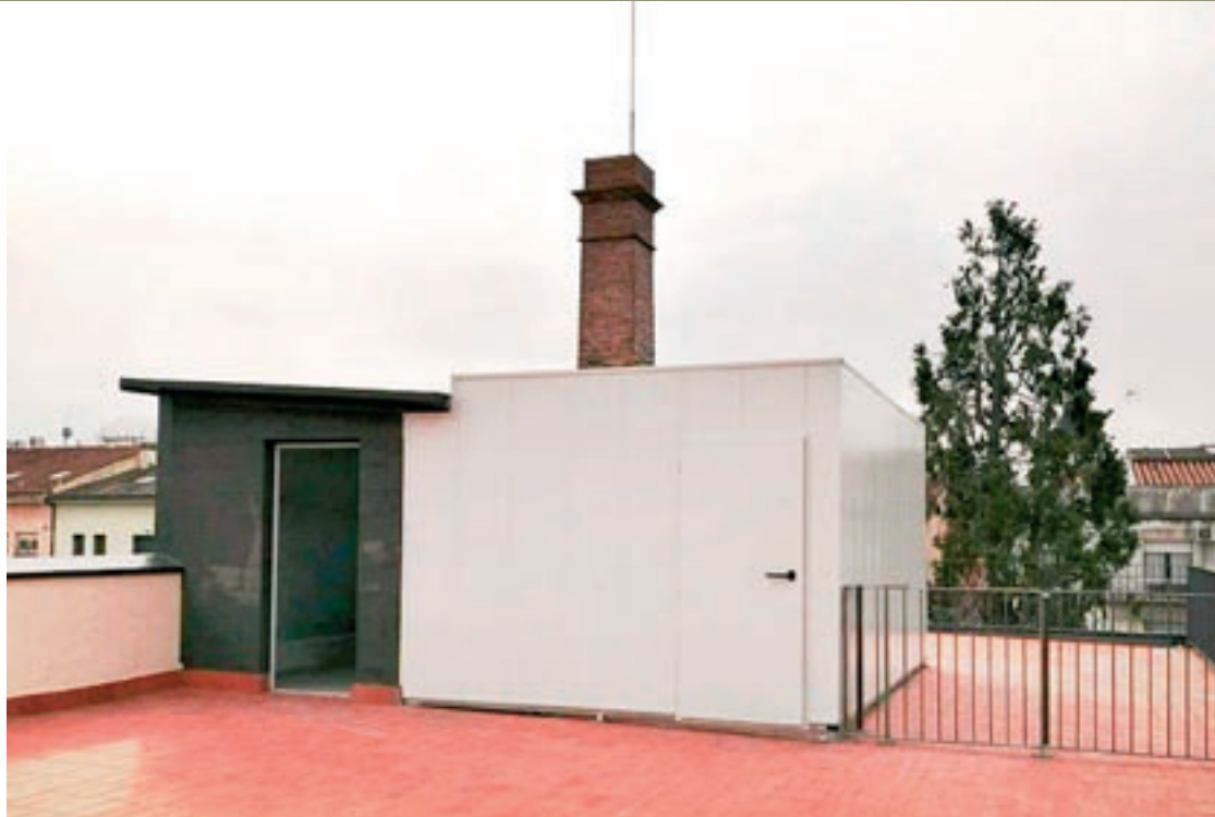
El sistema d'aïllament acústic col·locat a les bombes de calor de la Tèxtil Rase que redueix el soroll que fan
