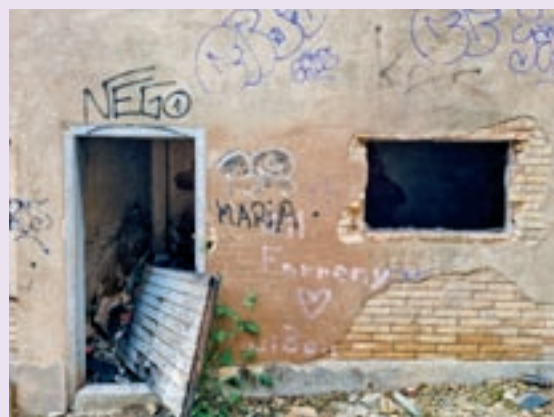
A dalt i a baix, estat precari dels edificis annexos, que han d'anar a terra; al mig, imatge parcial de les Cavallerisses
